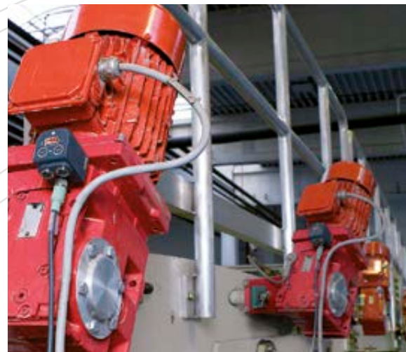
Sledování stavu stroje pomocí systému FAG SmartCheck
